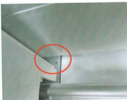
Figura 8 – Ingresso de água no perfil inferior, pressão de 190 Pa
