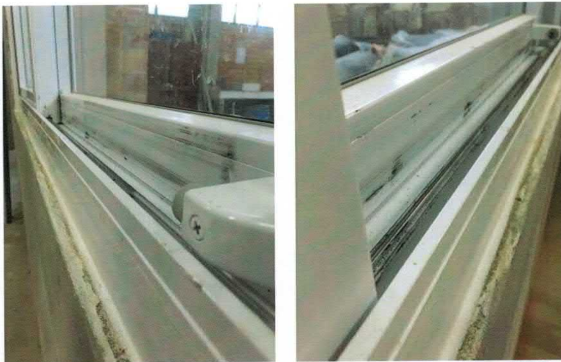
Figura 9 – Estado de conservação da esquadria após o ensaio de ciclo de abertura e fechamento
