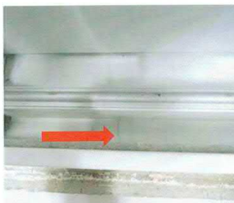
Figura 7 – Ingresso de água no perfil inferior, pressão de 60 Pa
