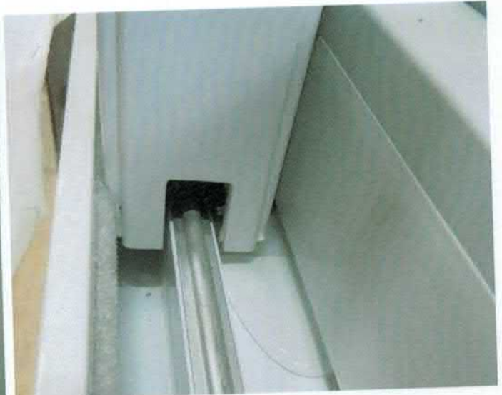
Figura 6 – Presença de bolhas no perfil inferior, pressão de 280 Pa.
